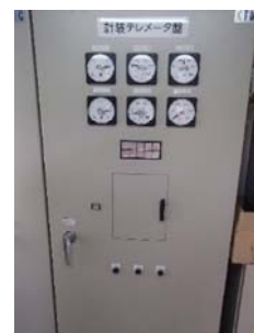
計装テレメータ盤
