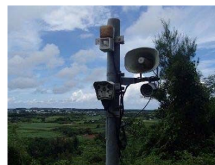
監視カメラ及び警報装置
