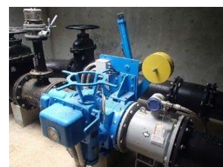
牧山配水池における 緊急遮断弁
