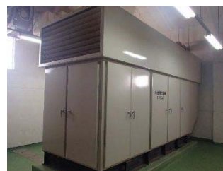
白川田水源地の 非常用自家発電設備
