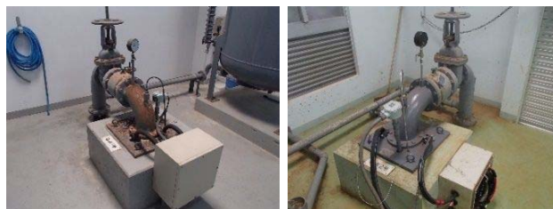
取水ポンプ設備
