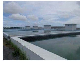
袖山浄水場の緩速ろ過池
