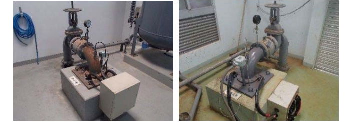
取水ポンプ設備
