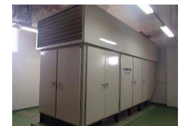
白川田水源地の非常用自家発電設備
