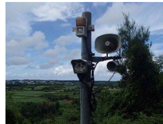
監視カメラ及び警報装置
