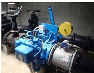
牧山配水池における緊急遮断弁
