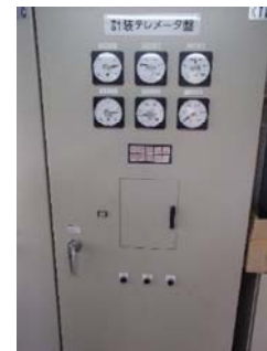
計装テレメータ盤
